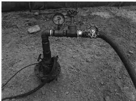
温泉井戸 源泉ポンプ吐出口
